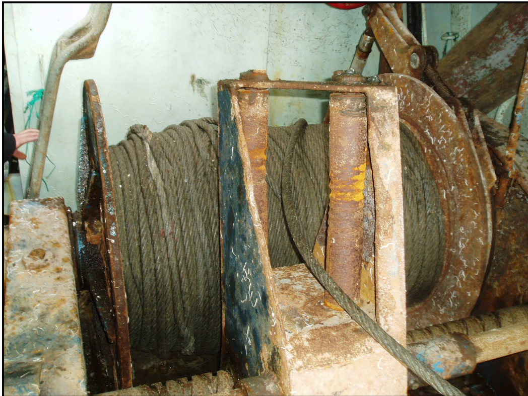
Vue du guide câble du treuil tribord.
