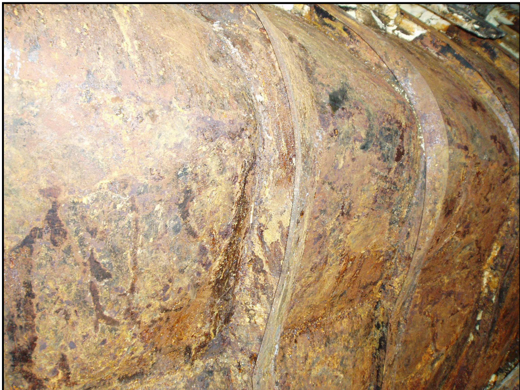
Photographie des déformations du bordé et des membrures dans la cale à poissons côté tribord.
