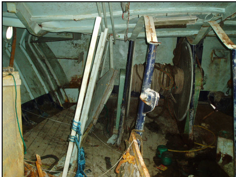
Vue des déformations au niveau du pont principal. La photographie est prise de l'arrière de la salle de travail.
