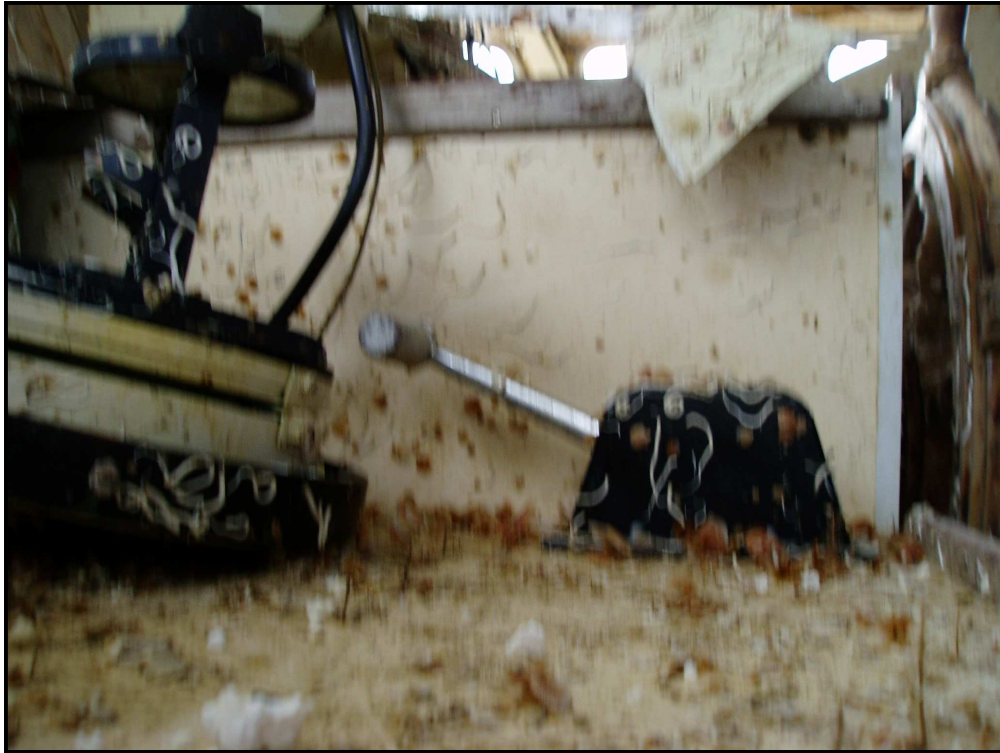
Vue de la manette de commande du moteur montrant que ce dernier était embrayé.
