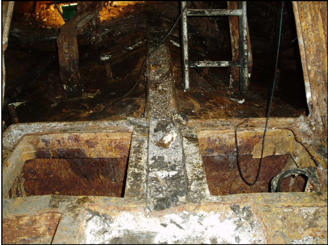
Déformation du double fond sous la cale à poissons. Vue prise au niveau du puisard.
