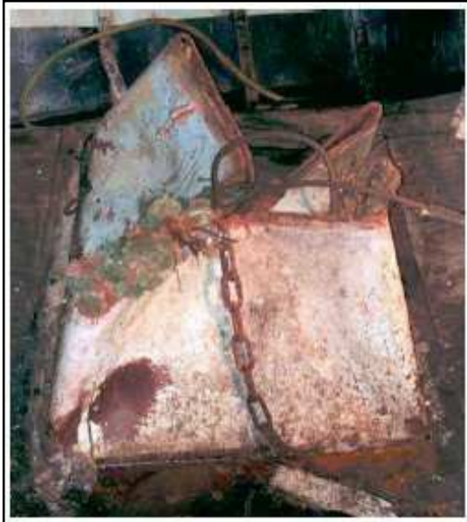
Déformations écouille tribord cale à poissons
