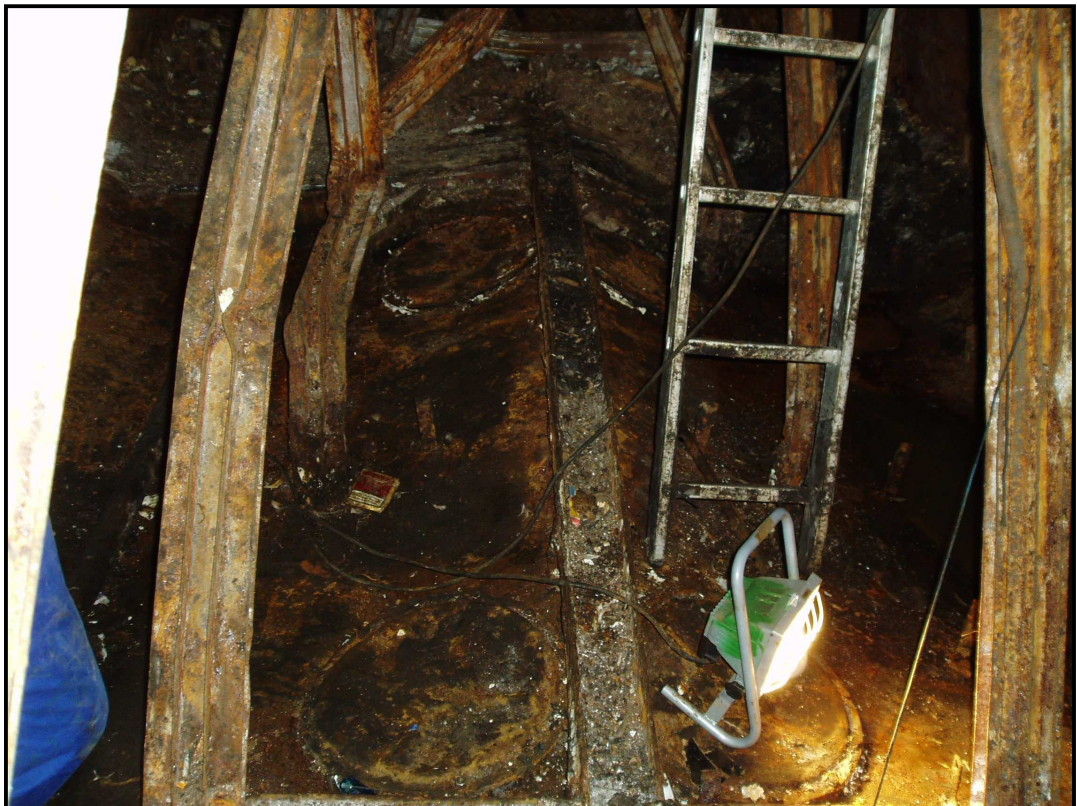
Déformation du plafond du double fond sous la cale à poissons. Vue prise de l'arrière vers l'avant de la cale à poissons en son milieu.
