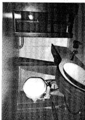
Une jolie façade lamellée, mais beaucoup de tuyaux apparents.
